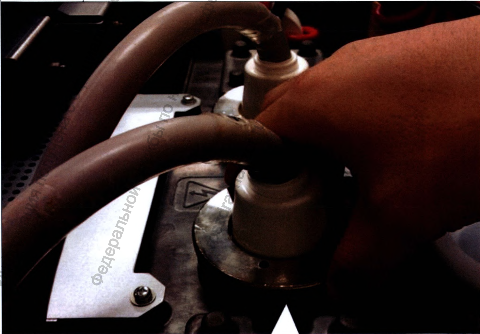
7. Кабель высокого напряжения.
