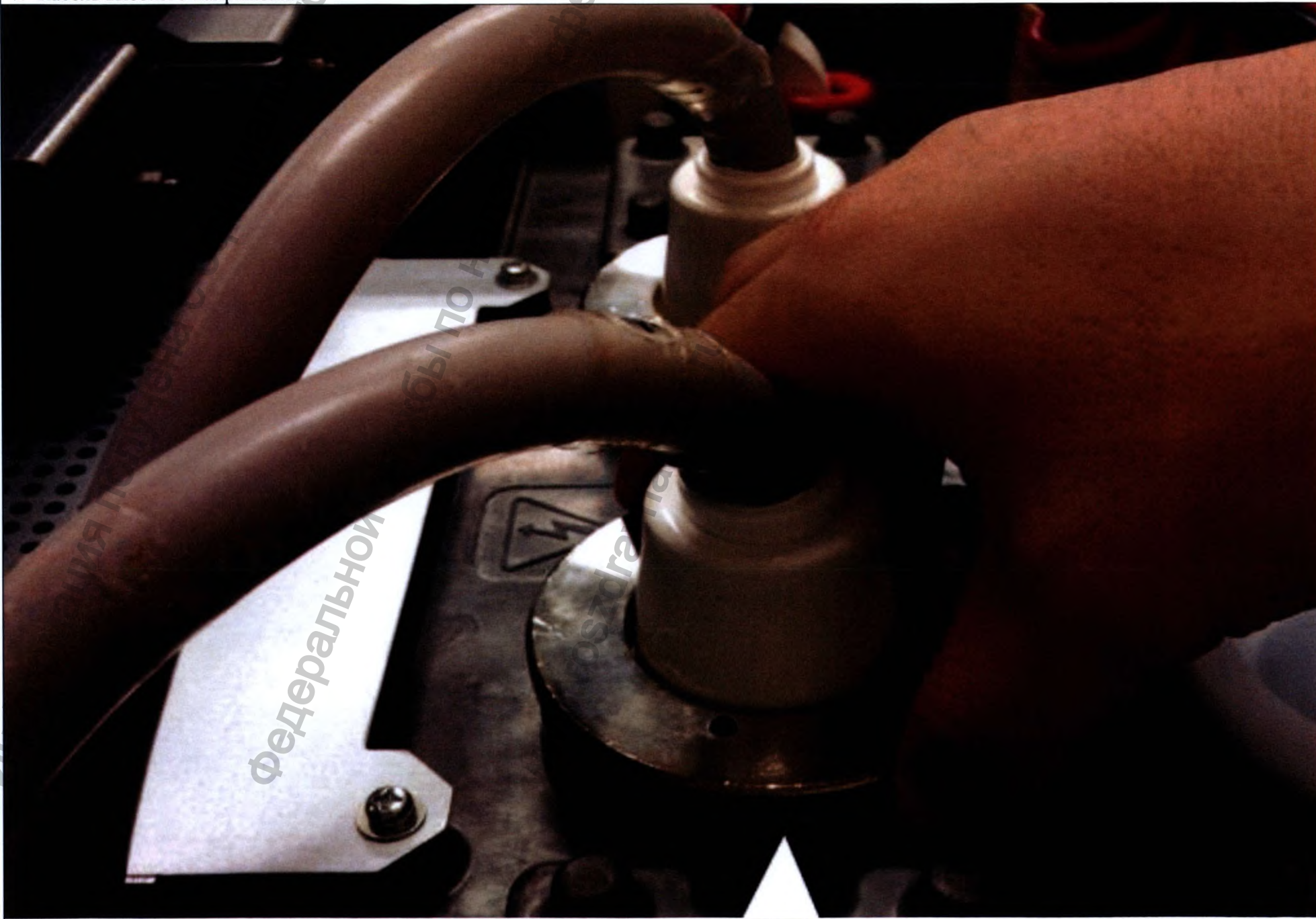
7. Кабель высокого напряжения.
