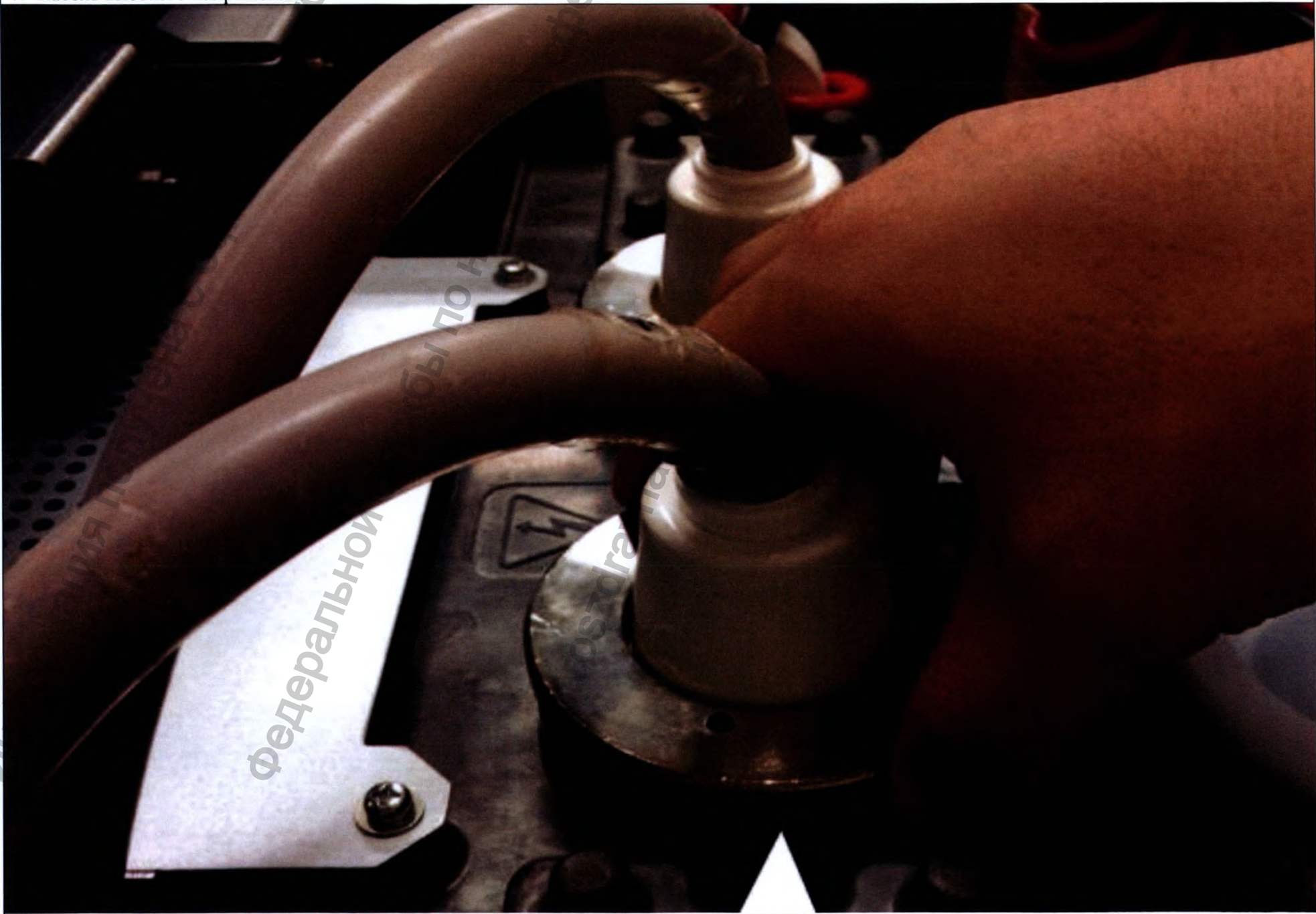
7. Кабель высокого напряжения.
